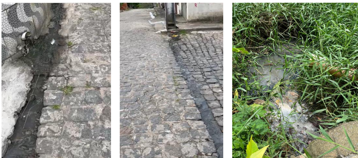
Esgotos domiciliares que desaguam no riacho da Fazenda Borborema
