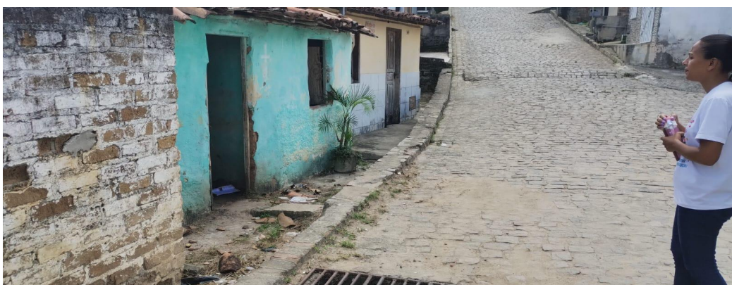
Minguara: casas com estruturas precárias
