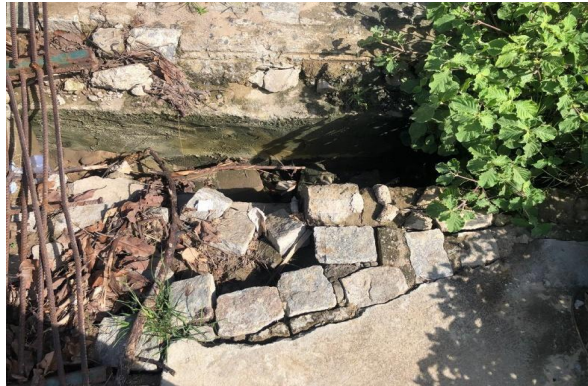
Avenida São Cristóvão, próximo a marmoraria: ponto de esgoto
